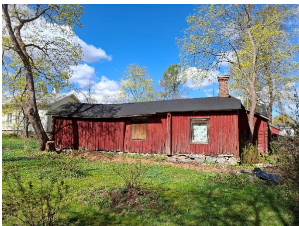
Kuva 17. Kievariosa on hyvin huonossa kunnossa. Leipintuvalla on korkeampi kivistä ladottu sokkeli ja yksiruutuinen lasi-ikkuna.
